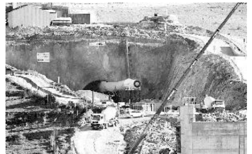
Aspecto que ofrecía ayer la boca de la cara norte del Cerro de San Pedro, en cuyo interior se han producido los desplomes que han sepultado una de las dos la tuneladoras
