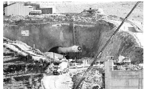
Aspecto que ofrecía ayer la boca de la cara norte del Cerro de San Pedro, en cuyo interior se han producido los desplomes que han sepultado una de las dos la tuneladoras
